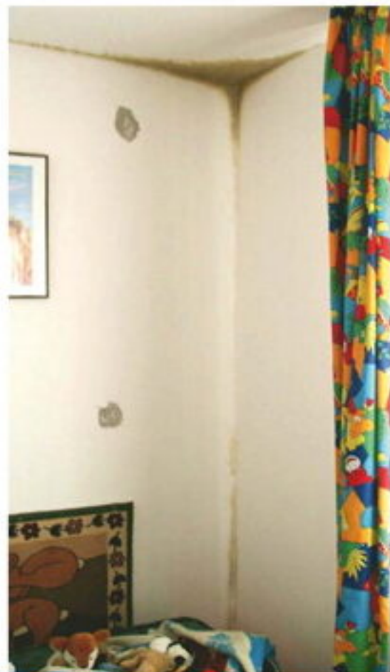
Imaginea 138. Formarea mucegaiului în colțul „pozitiv”, în camera copiilor
