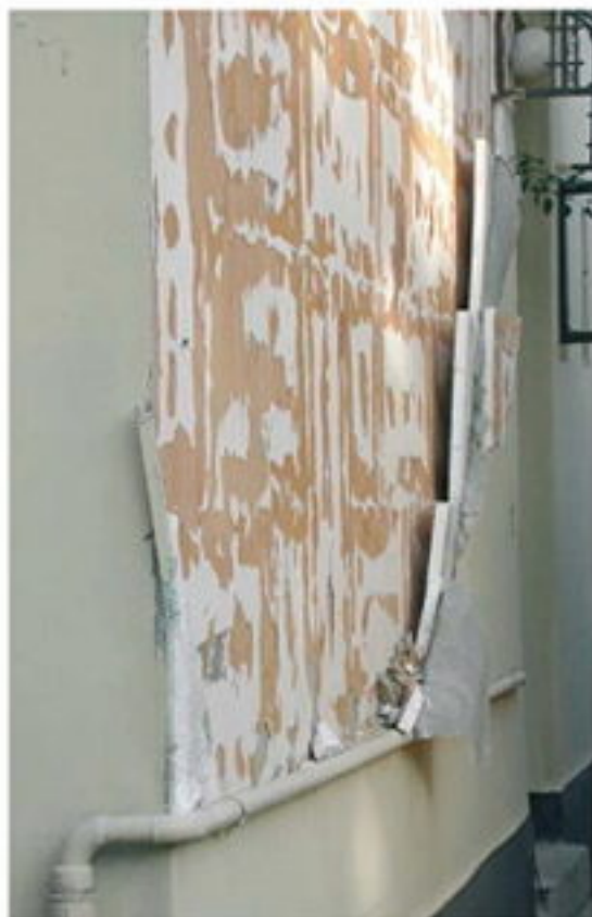
Imagina 182. Desprinderea termoizolației din cauza fixării greșite
